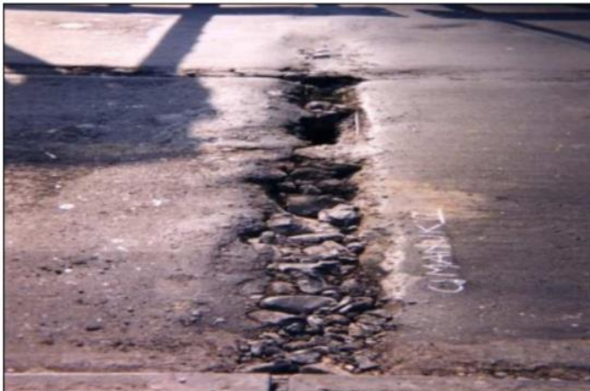
Gambar 7. Contoh siar muai yang mengalami kerusakan
