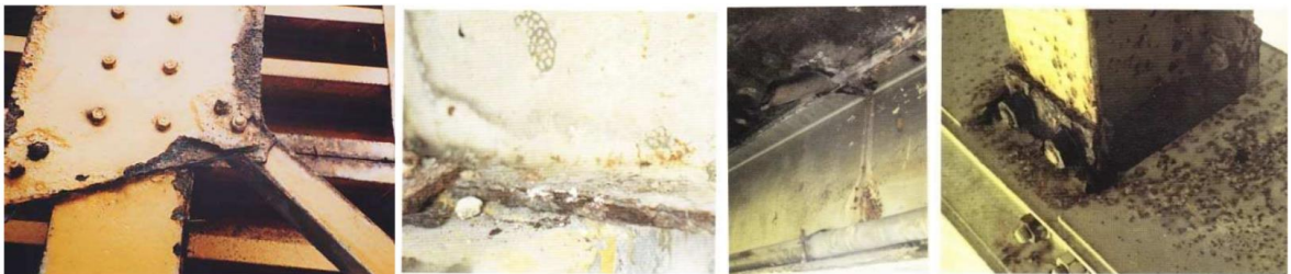
Gambar 2. Contoh kerusakan unsur jembatan akibat karat
